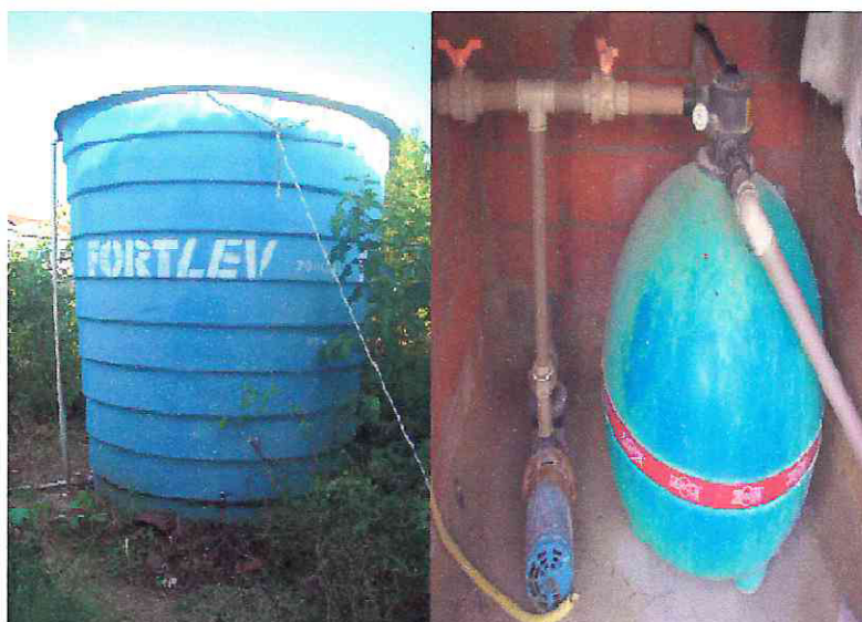
Figura 14: Tanque reservatório de 20.000 L (à esquerda) e Filtro de areia acoplado à eletrobomba (à direita).
