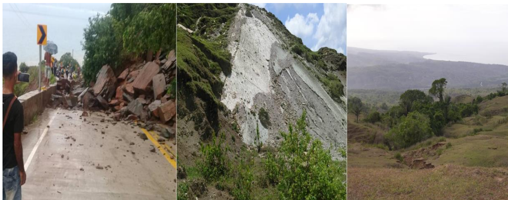
Figura 29–Deslizamento da Costa Norte e erosão interiorana da Costa Sul e do Leste. Foto: Santos (2018), Cruz (2015) e Trainor (2005).
