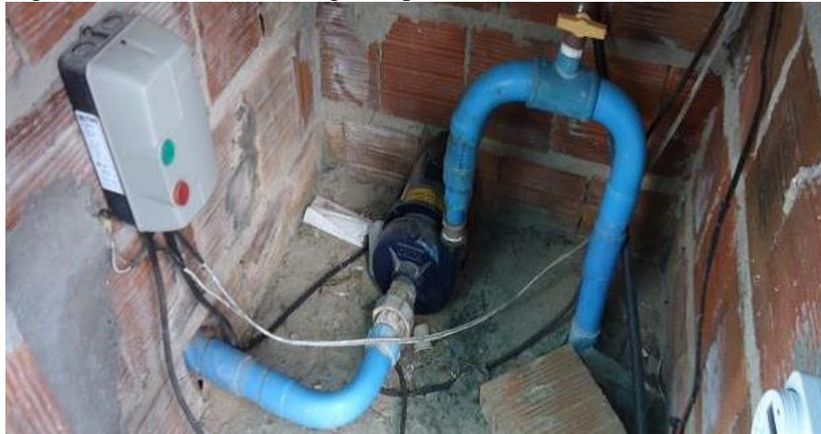
Figura 12 – Bomba centrífuga acoplada a um motor de 1/3 de CV
