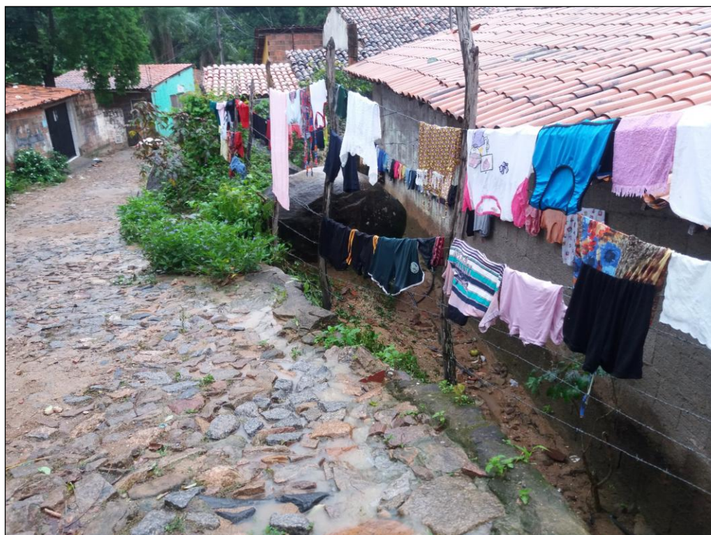
Figura 41 – Precarização nas estruturas de drenagem, fomentando a condição de vulnerabilidade ao Movimento de Massa.
