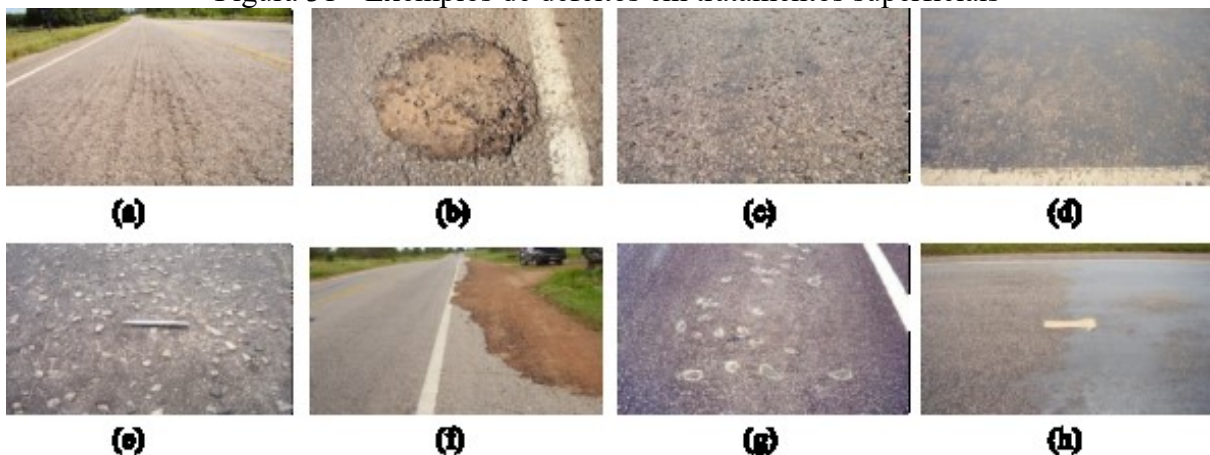
Figura 31 - Exemplos de defeitos em tratamentos superficiais
