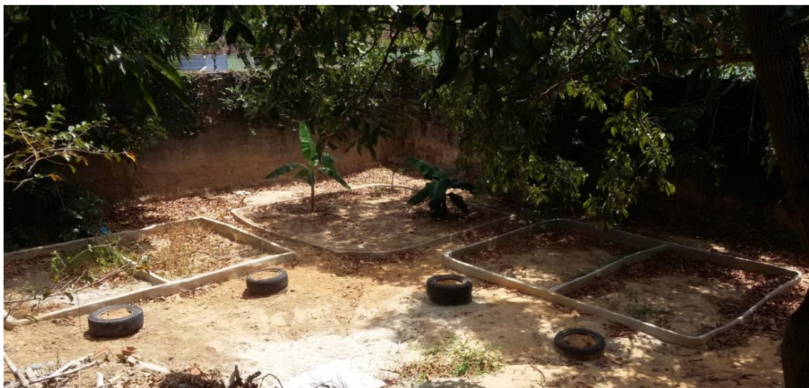
Figuras 36 – Sistema integrado concluído.
