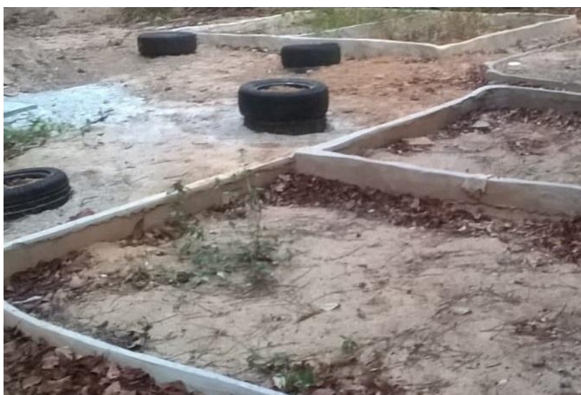
Figura 34 – Perspectiva dos tanques instalados no sistema.
