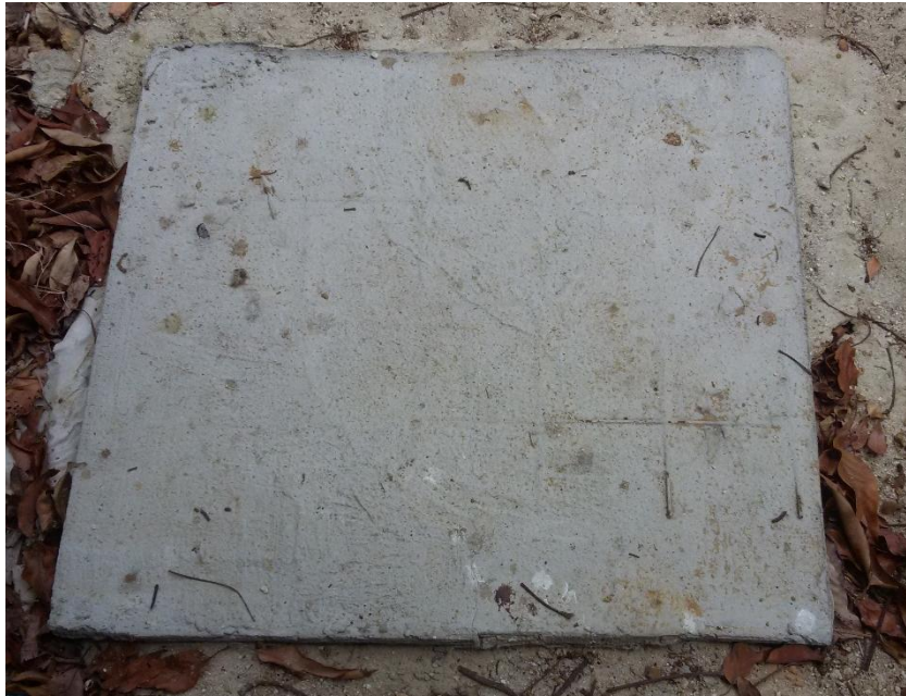
Figura 35 – Caixa de distribuição.
