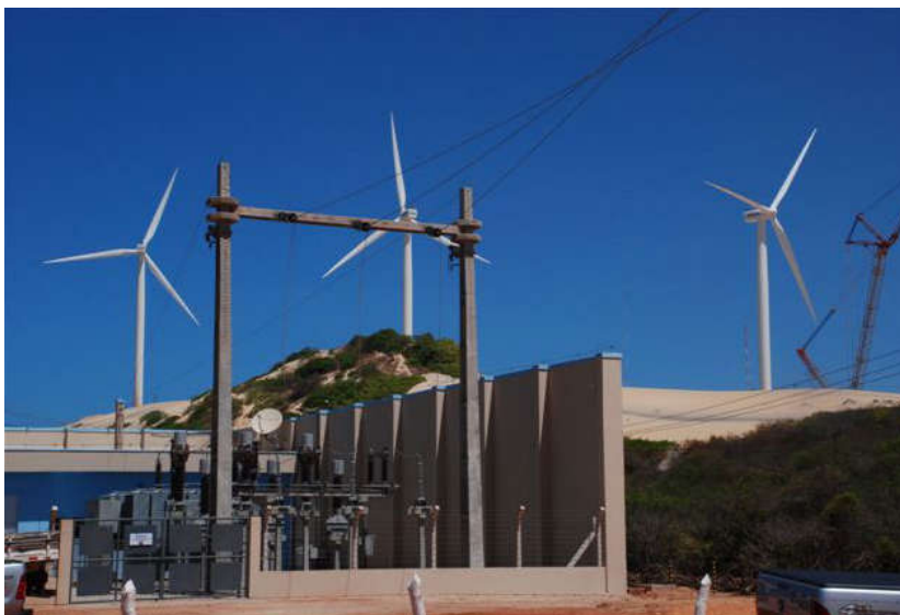
Figura 9 – Subestação do parque eólico Canoa Quebrada
