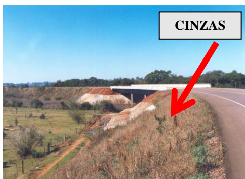
Figura 11 - Aterro construído com cinzas ligando os municípios de São Jerônimo/RS e General Câmara/RS
