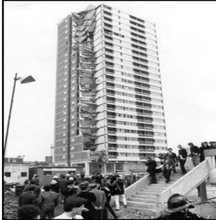
Figura 1 – Edifício Ronan Point após o colapso.
