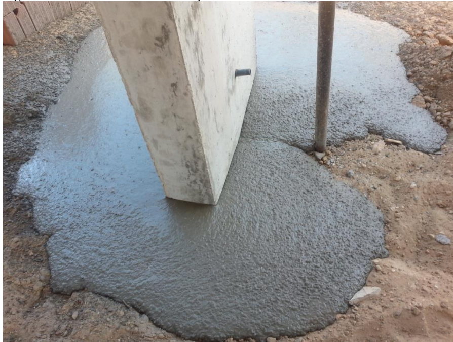
Figura 25 - Vazamento de concreto pelas fôrmas.
