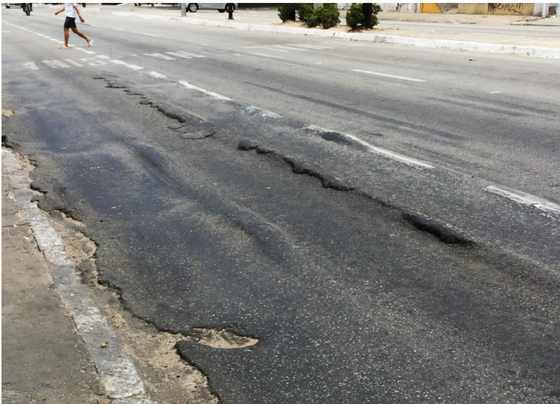
Figura 1. Afundamento de trilha de roda em pavimento urbano.
