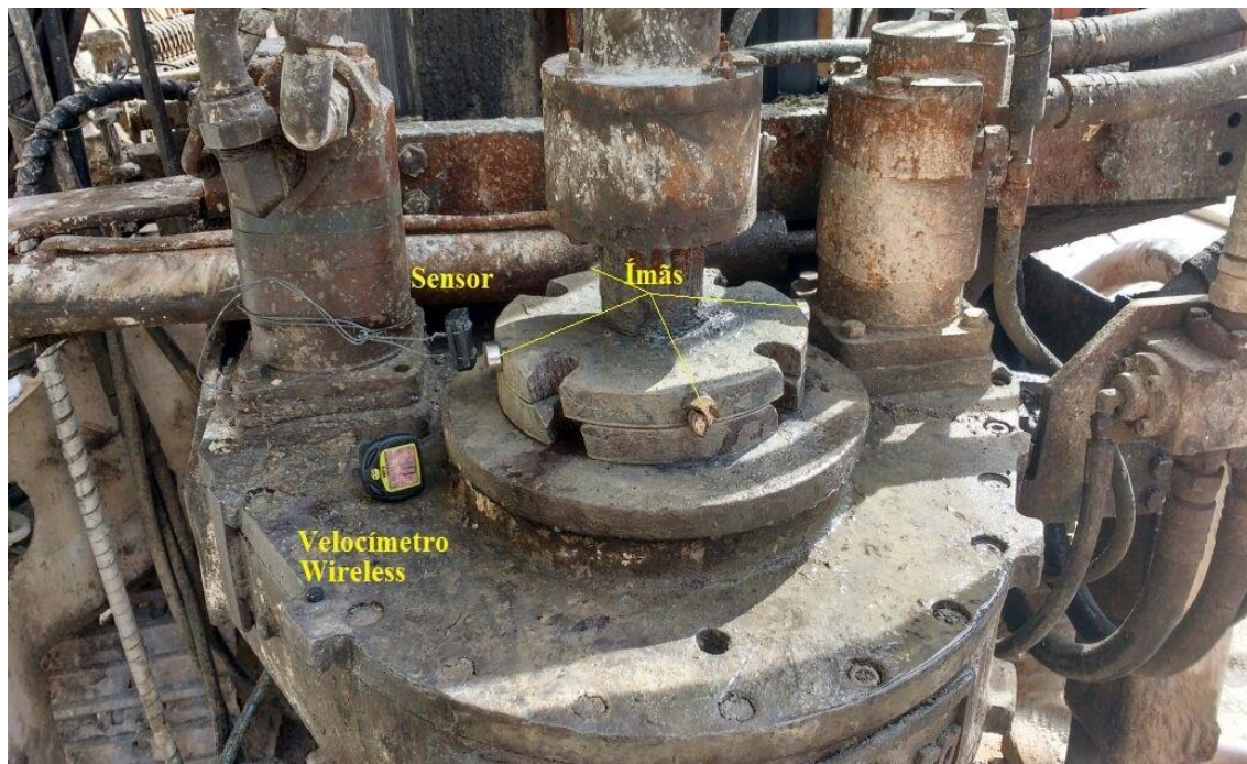
Figura 4.29 – Equipamento de monitoramento proposto instalado e seus componentes.
