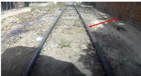
Figura 20 – Invasão à faixa de domínio
