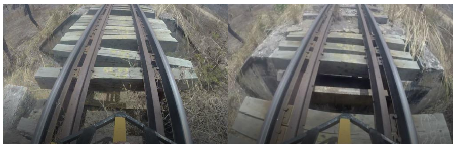
(d) Severidade 3: Dormentes deslocados e faltando
