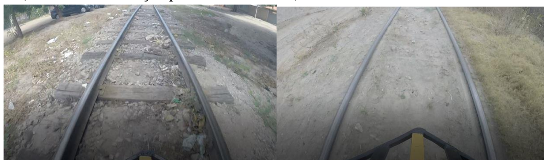
c) Nível 2: Pouca brita visível ou dormentes não estão visíveis
