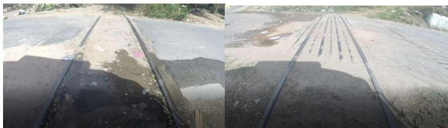
(a) PN com água acumulada no pavimento
