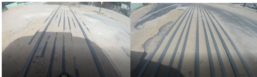
(a) PN com pavimento asfáltico deteriorado
