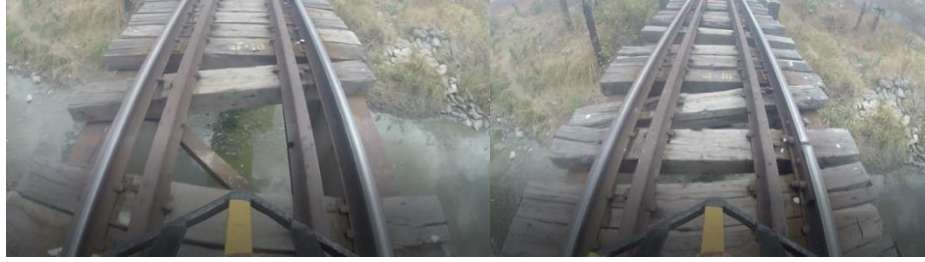
(e) Severidade 4: Dormentes rachados, deslocados e faltando
