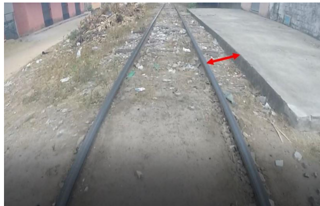
Figura 39 – Situação crítica de invasão à faixa de domínio
