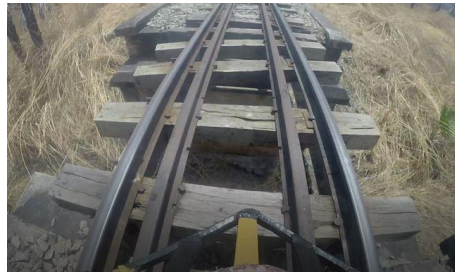
(b) Severidade 1: Dormentes deslocados e dormente rachado
