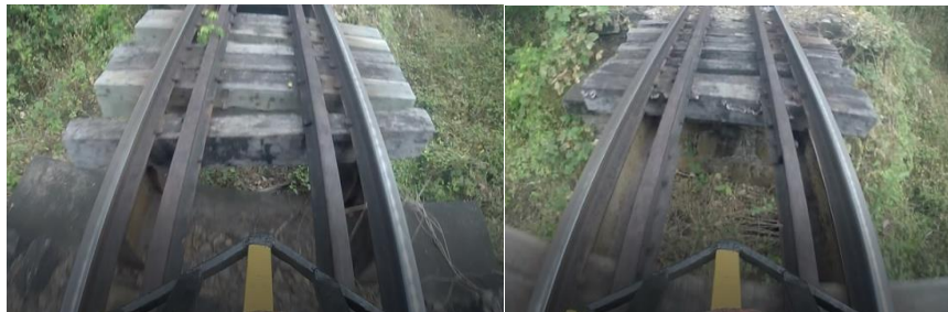
(c) Severidade 2: Dormentes faltando
