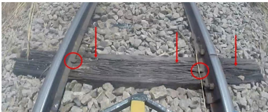
Figura 24 – Fendas de dormente situado na junta e suas fixações
