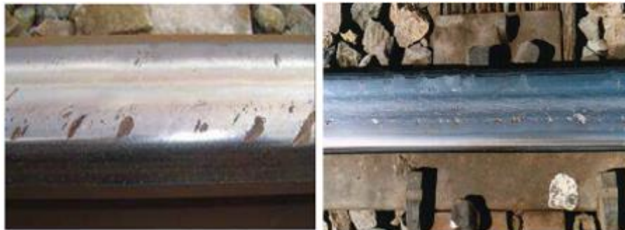
(a) Fissuração no canto da bitola (b) Escamação do boleto
