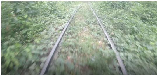
Figura 17 – Presença de vegetação na via permanente
