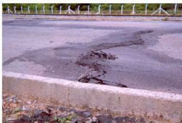
Figura 4 - Deterioração em pista com a utilização de escória não curada
