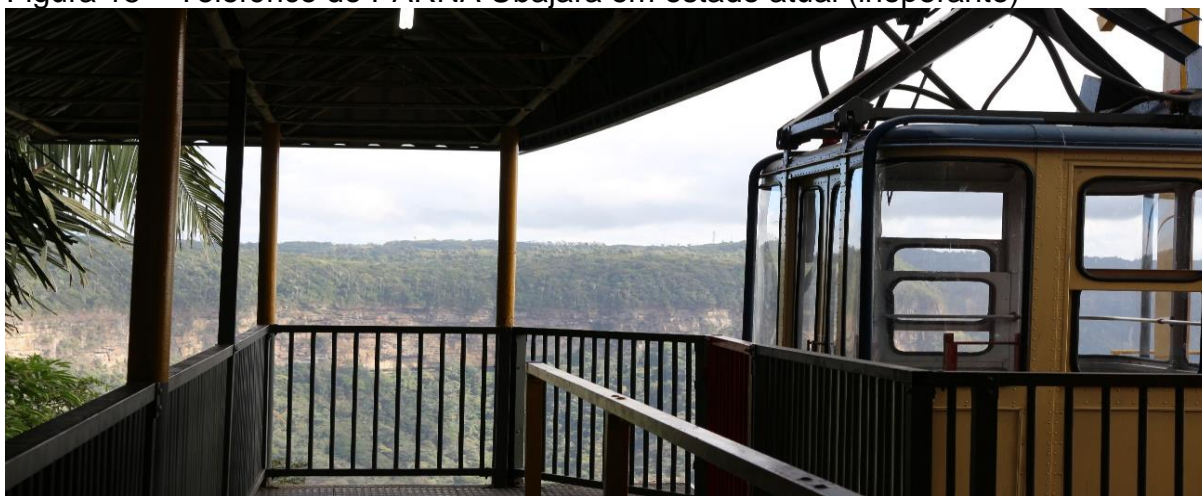
Figura 15 – Teleférico do PARNA Ubajara em estado atual (inoperante)
