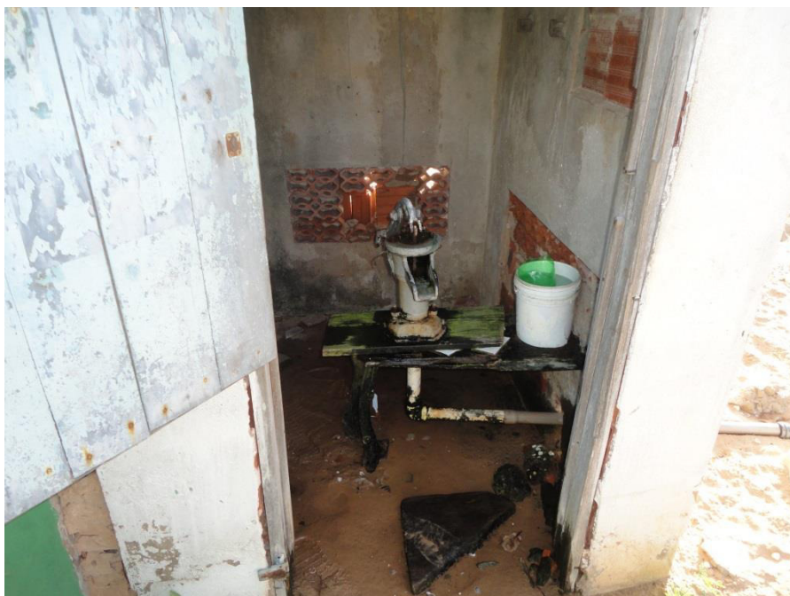
Figura 14 - Poço IS15, com bombeamento manual, localizado na zona urbana de Icapuí
