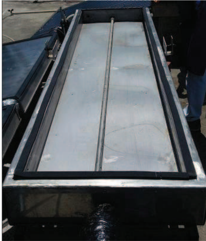
Figura 9: Tanque de armazenamento
