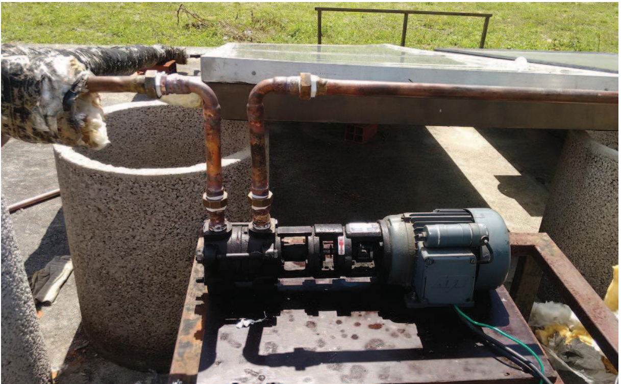
Figura 13: Bomba de deslocamento positivo acoplada ao sistema.
