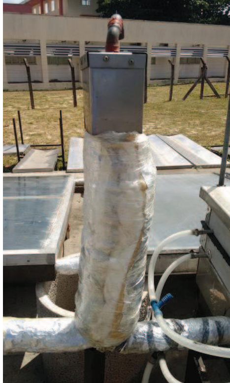
Figura 14: Tanque de expansão
