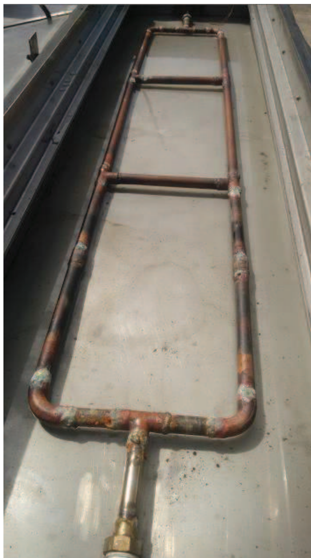
Figura 19: Trocador de calor instalado no tanque de armazenamento
