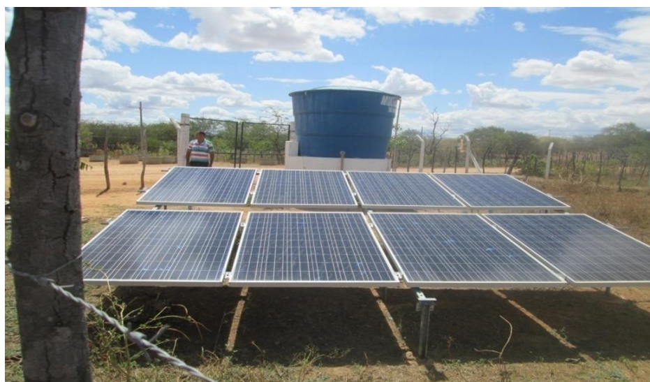
Figura 9 - Placas solares utilizadas para bombeamento da água na Comunidade de Arção (região da Pedra - Apodi).
