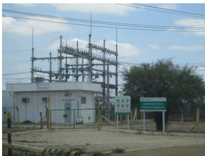
Figura 38 - Imagem da Sub-Estação Riacho da Forquilha (Região da Chapada - Apodi).
