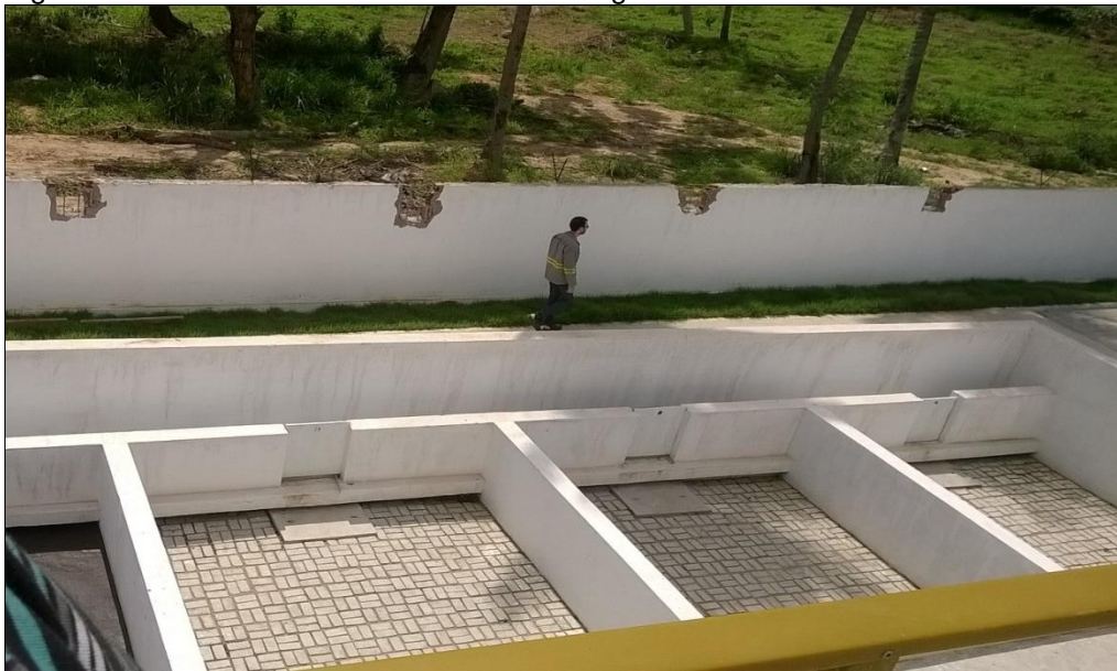
Figura 36 – Erro construtivo nos leitos de secagem
