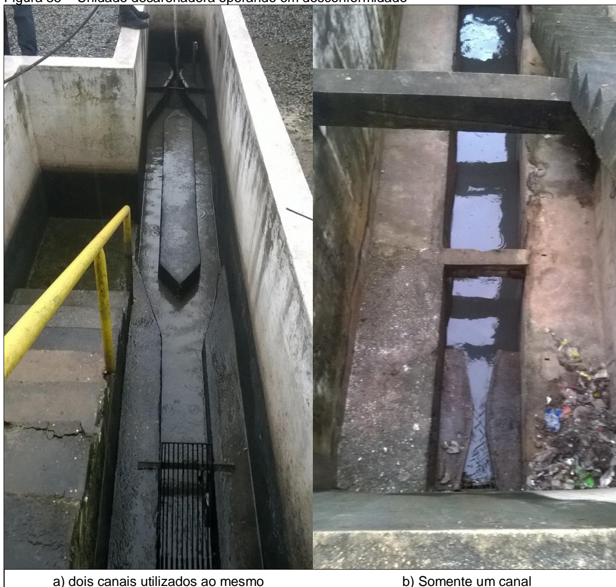
Figura 35 – Unidade desarenadora operando em desconformidade
