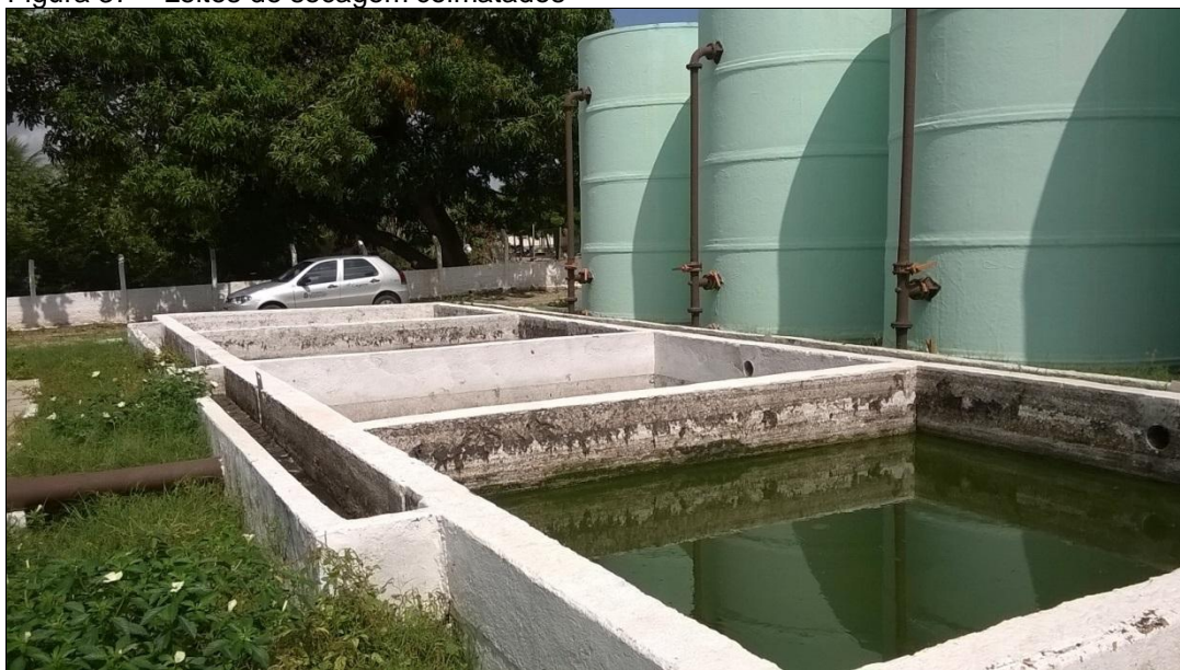
Figura 37 – Leitões de secagem colmatados
