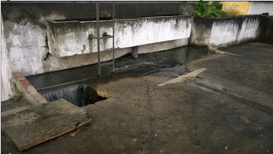
Figura 45 – Transbordamento de efluente em ETE com decanto digestor
