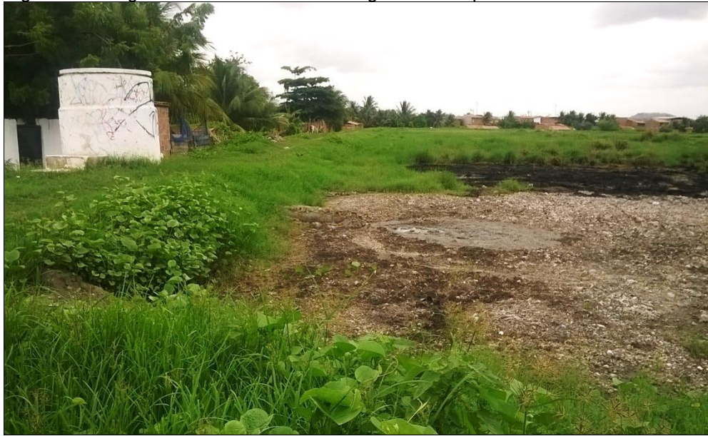
Figura 42 – Lagoa anaeróbia com elevado grau de comprometimento
