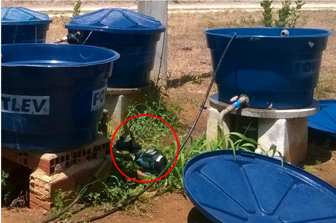
Figura 8: Disposição das caixas d'água, com detalhe na motobomba
