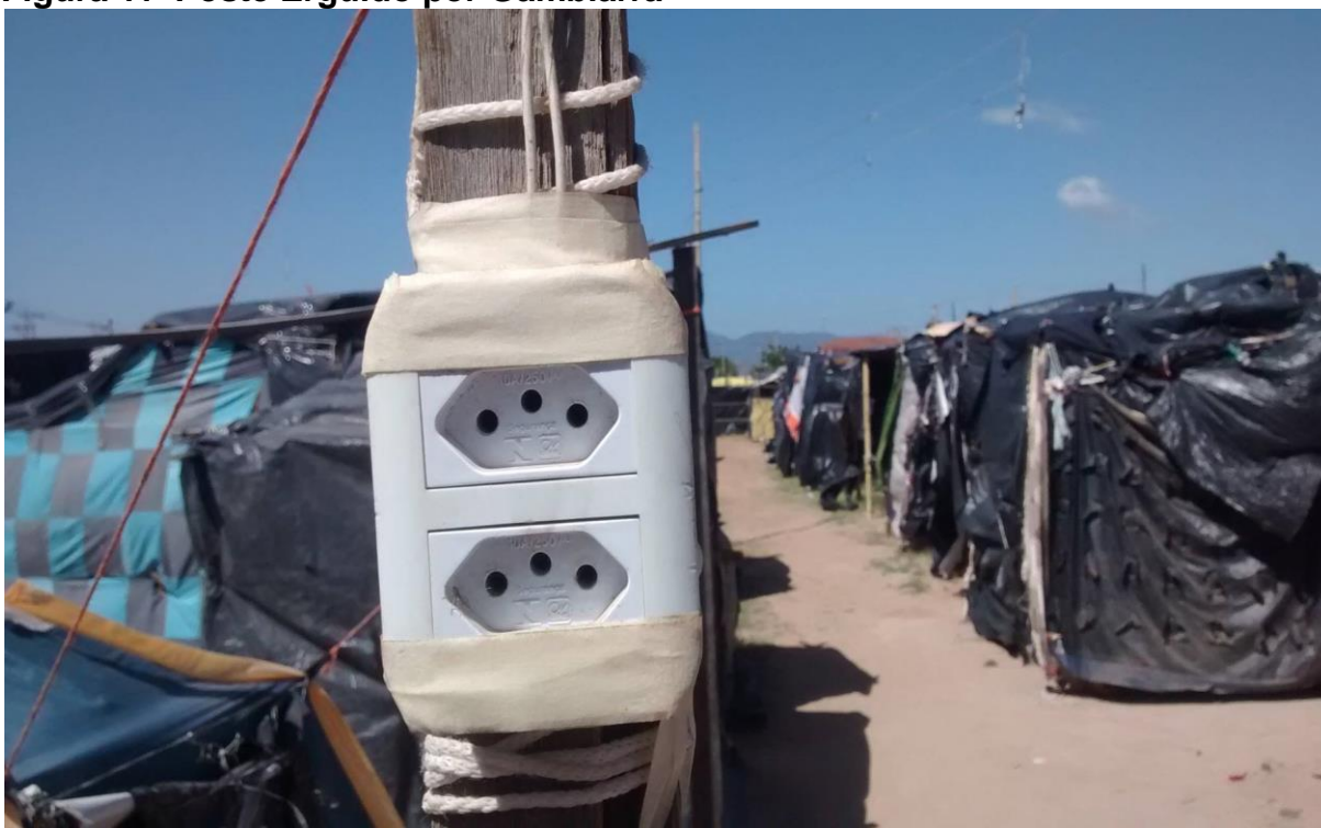
Figura 11–Poste Erguido por Gambiarra
