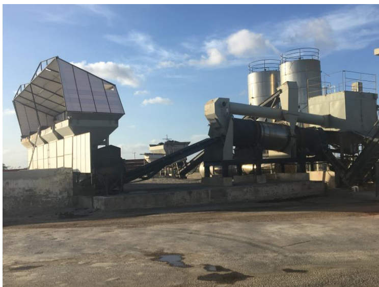
Figura 14: Usina asfáltica de produção contínua
