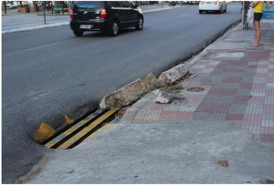
Figura 3.13 – Condições físicas de calçada/via no bairro Meireles, em Fortaleza.
