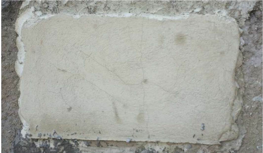
Figura 29 - Fissuras no painel de argamassa
