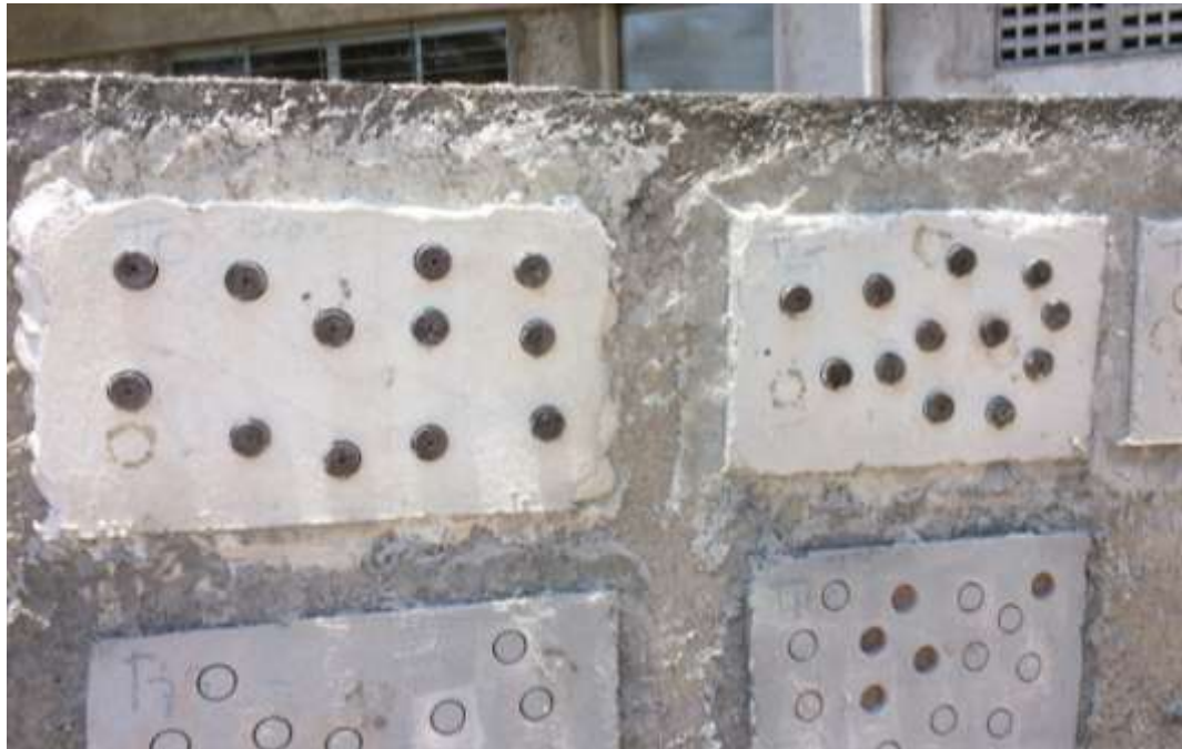
Figura 32 - Pastilhas coladas no revestimento
