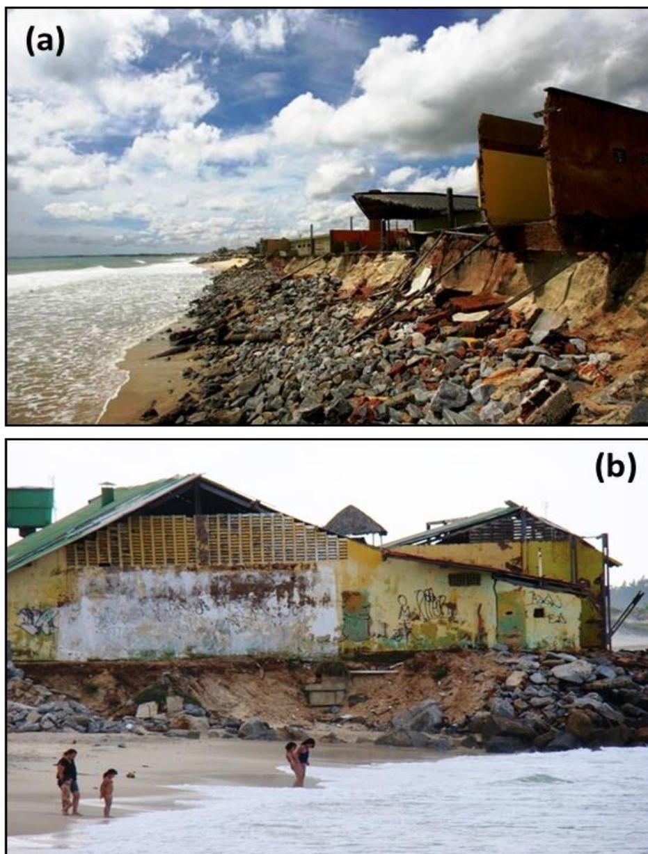
Figura 11 – Impactos da erosão costeira nas edificações da praia do Icaraí.
