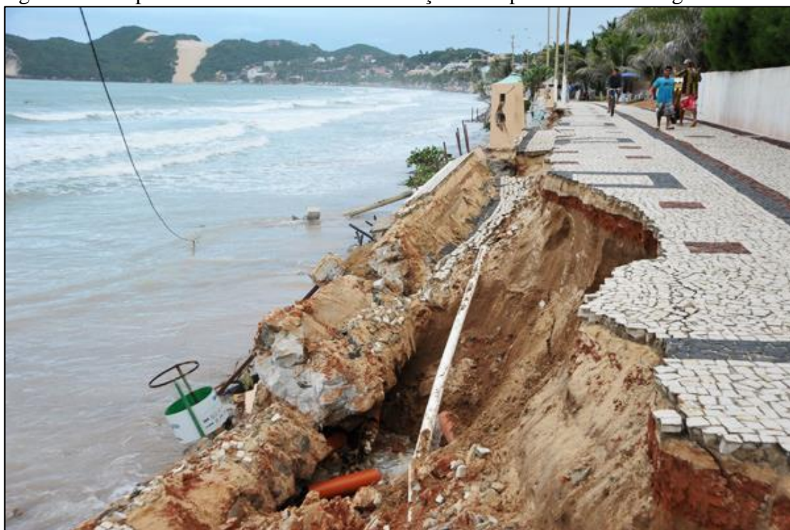
Figura 19 – Impactos da erosão costeira no calçadão da praia de Ponta Negra/RN.
