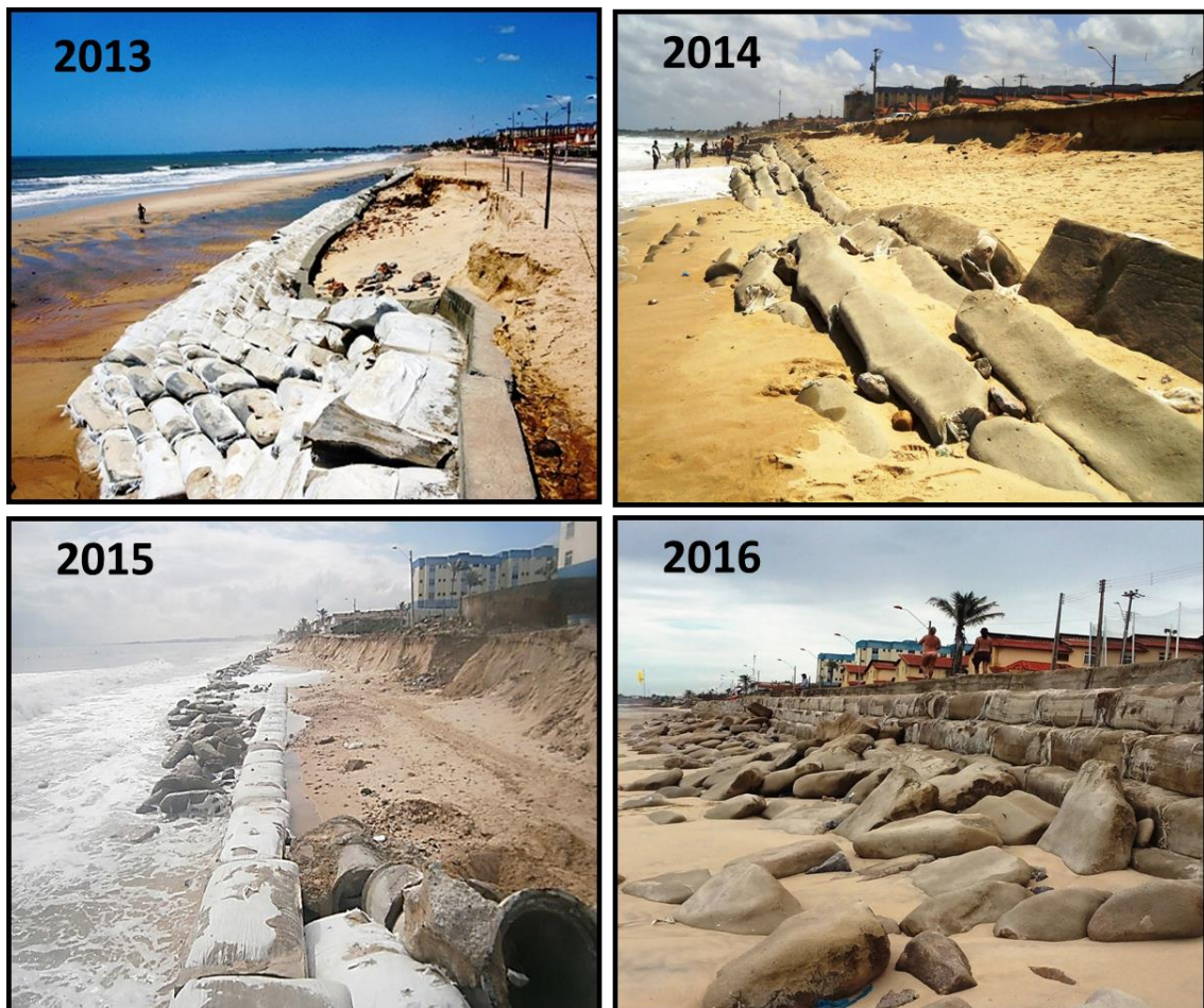
Figura 16 – Fotografias do colapso da estrutura do Bagwall na Praia de Icará/CE de 2013 a 2016.
