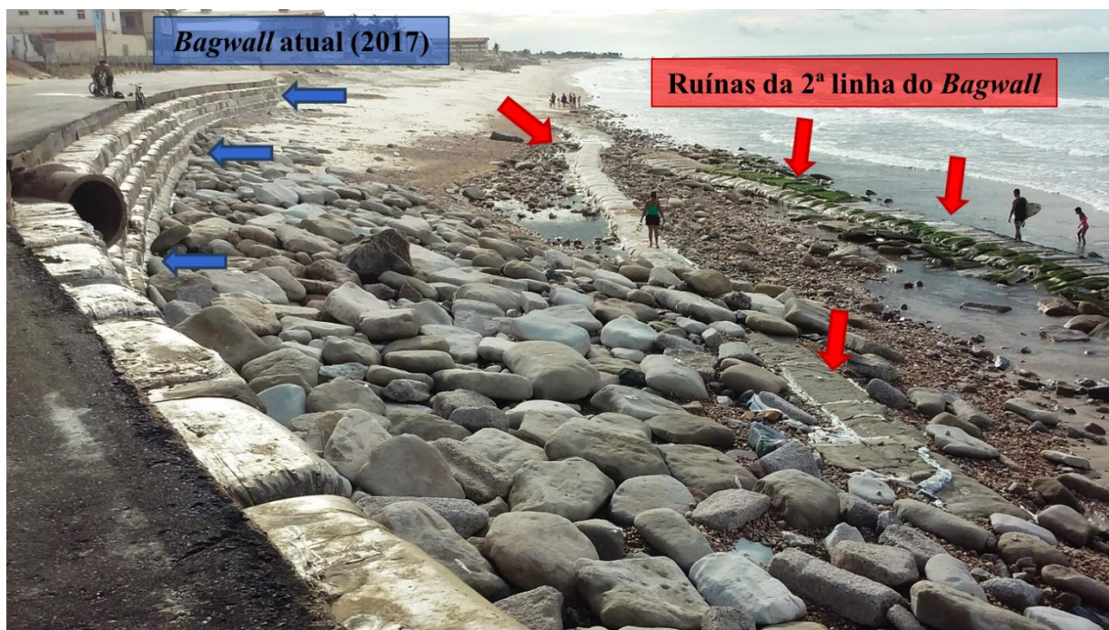
Figura 27 – Situação atual do Bagwall e ruínas da segunda linha da obra.
