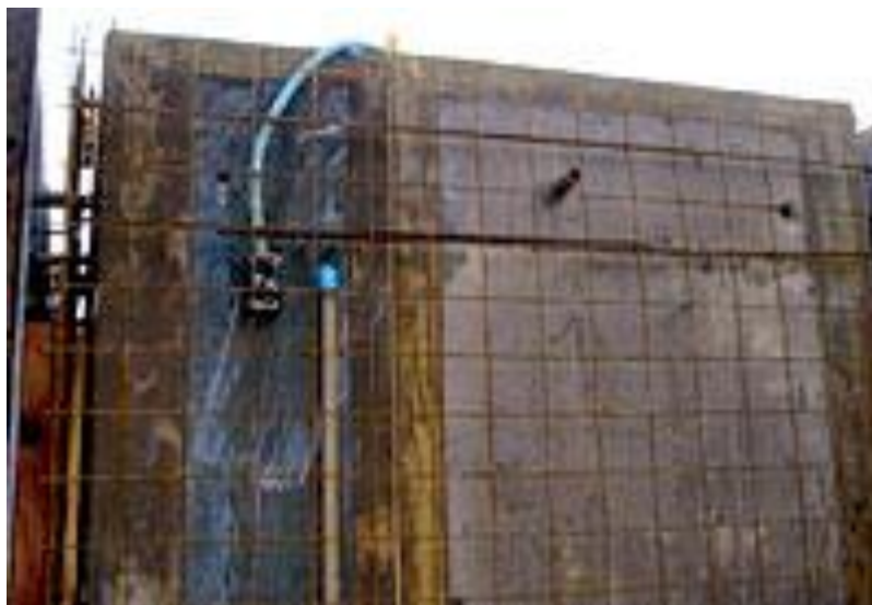
Figura 2.3 - Instalações embutidas nas paredes de concreto.
