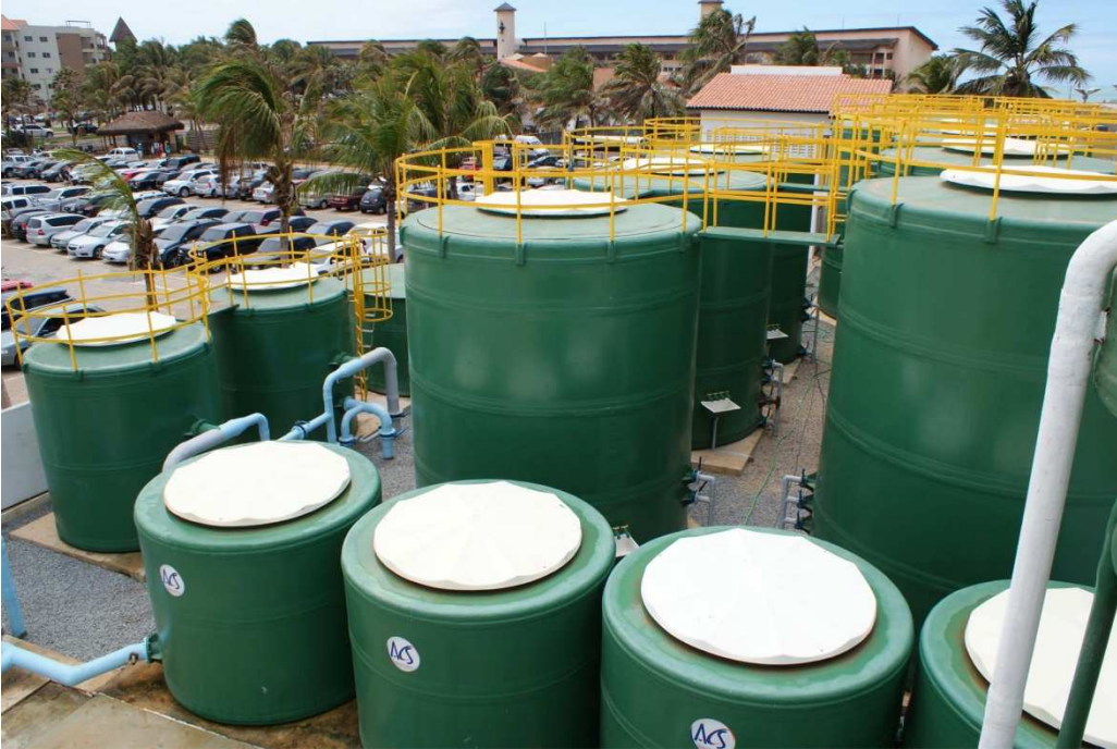
Figura 10 – ETE com reúso do Complexo Beach Park
