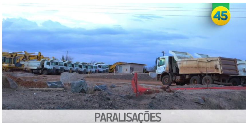
Figura 37 - Paralisação de obras da Transposição do Rio São Francisco
