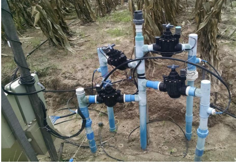
Figura 19: Cavalete de válvulas com quatro válvulas solenoides do tipo Latch
