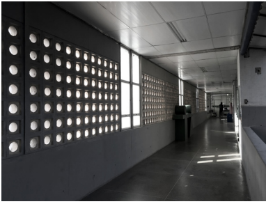
Figura 2.42. – Co-bogós nos corredores que conectam os blocos administrativos Fonte: Acervo do autor.
