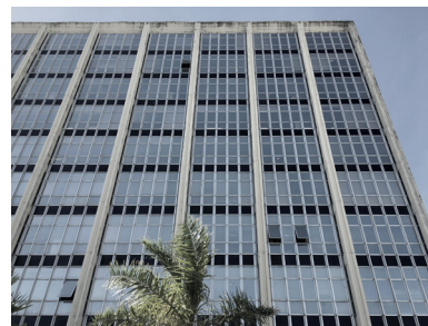
Figura 2.13. – Pilares em 'H' na fachada sul do edifício Fonte: Acervo do autor.
