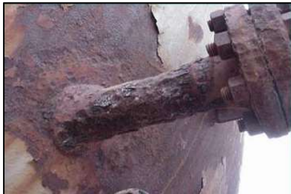
Figura 10 – Corrosão em bocal de um recipiente à pressão
