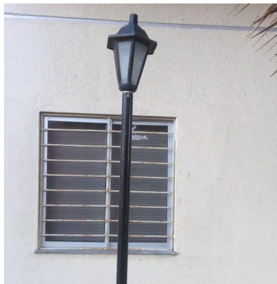
Figura 50 – Poste de iluminação localizada no LESC
