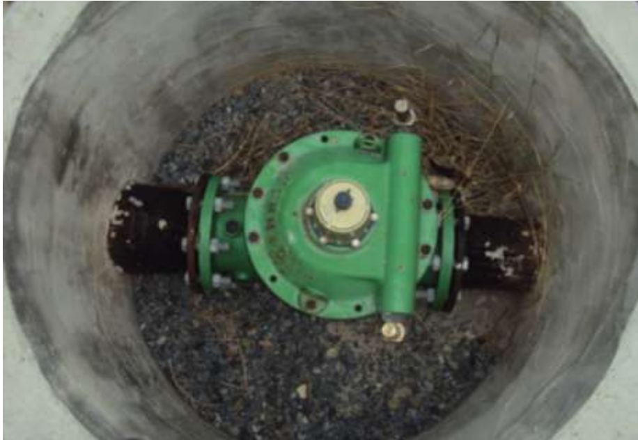
Figura 7 - Hidrômetro instalado nos lotes de oito hectares do Perímetro.
