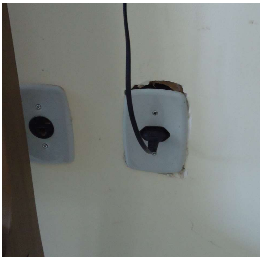
Figura 87 – Instalação de tomada, danificando acabamento de parede
