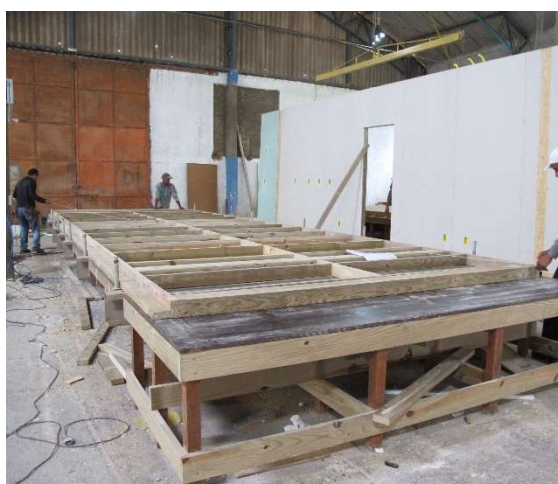
Mesa de montagem de painéis
