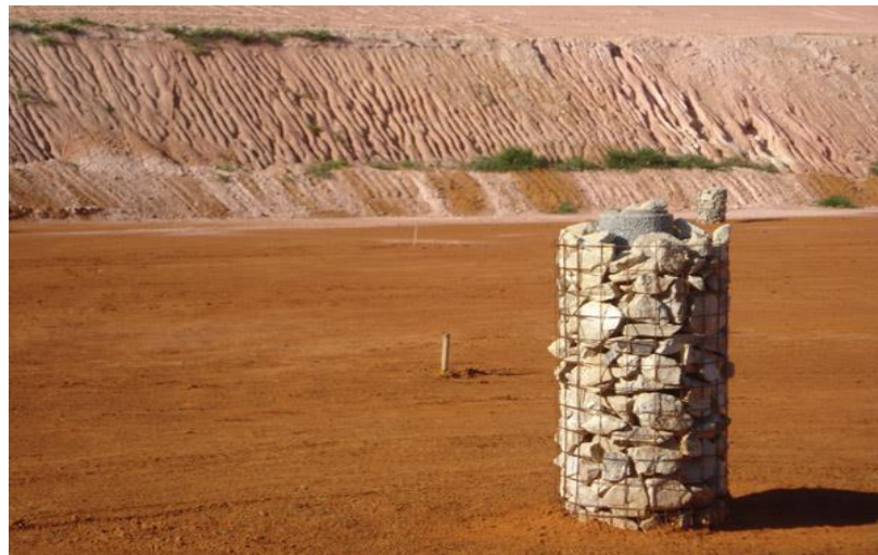
Figura 4 - Dreno de captação e escape de gás de aterro.
