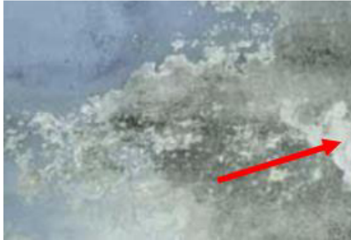
Figura 2 - Eflorescência no concreto
