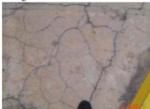
Figura 3 - Fissuras devido a RAA
