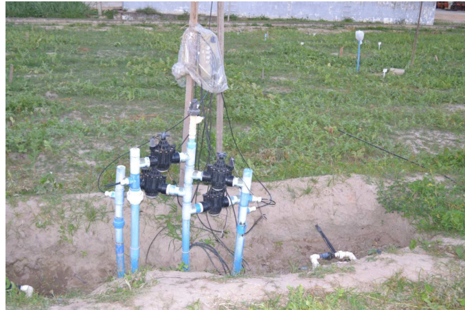
Figura 5- Cavalete das válvulas
