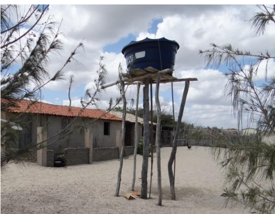
E – Instalação canalizada com bomba elétrica na comunidade de Xavier
