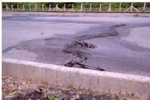
Figura 5 - Erupções e rachaduras em pista com a utilização de escória não curada
