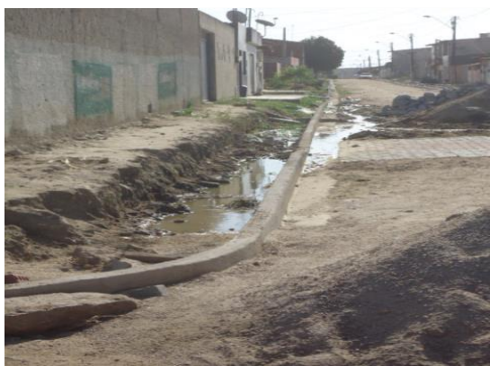
Figura 19 - Distrito de Jurema – Bairro Arianópolis – Esgotos a céu aberto.
