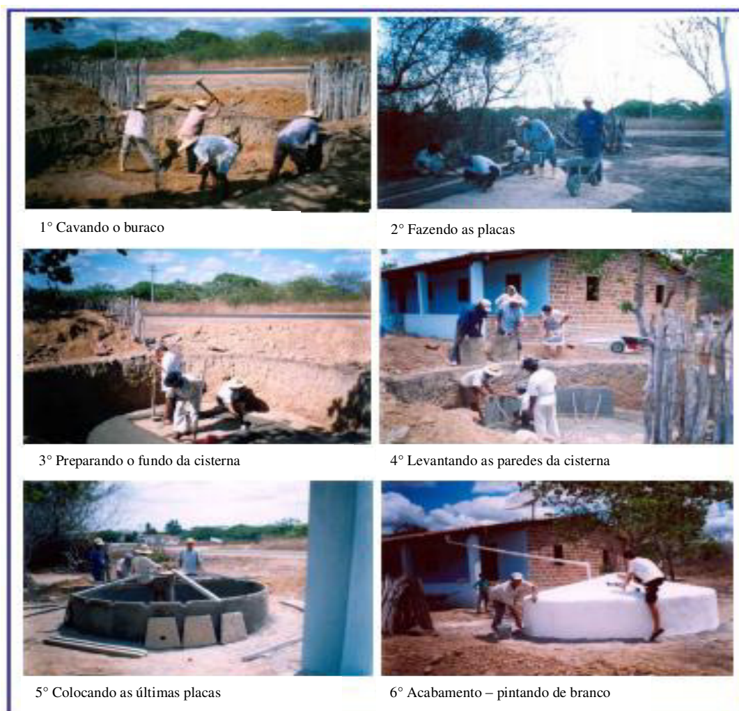
Figura 27 – Construção de cisterna de placas com recursos da CPT-CE em Independência - CE, 2006 Fonte: Silva, Danielle Rodrigues (2008).
