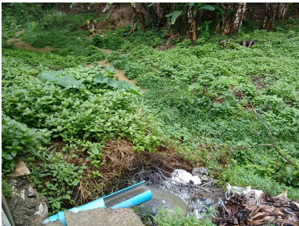
Figura 79-Detalhe da vazão do efluente da ETE 13 de Maio lançado no Rio Pacoti
