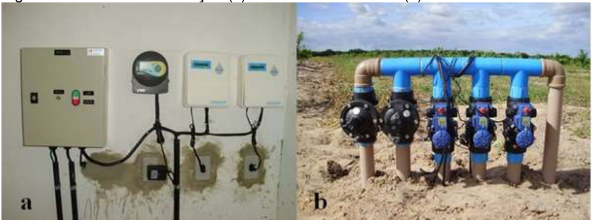
Figura 8 – Painel de automação (a) e válvulas solenoides (b).
