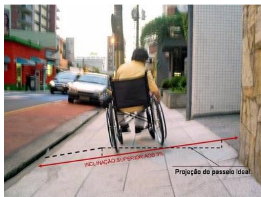
Figura 2.13: Calçada com inclinação transversal acentuada.
