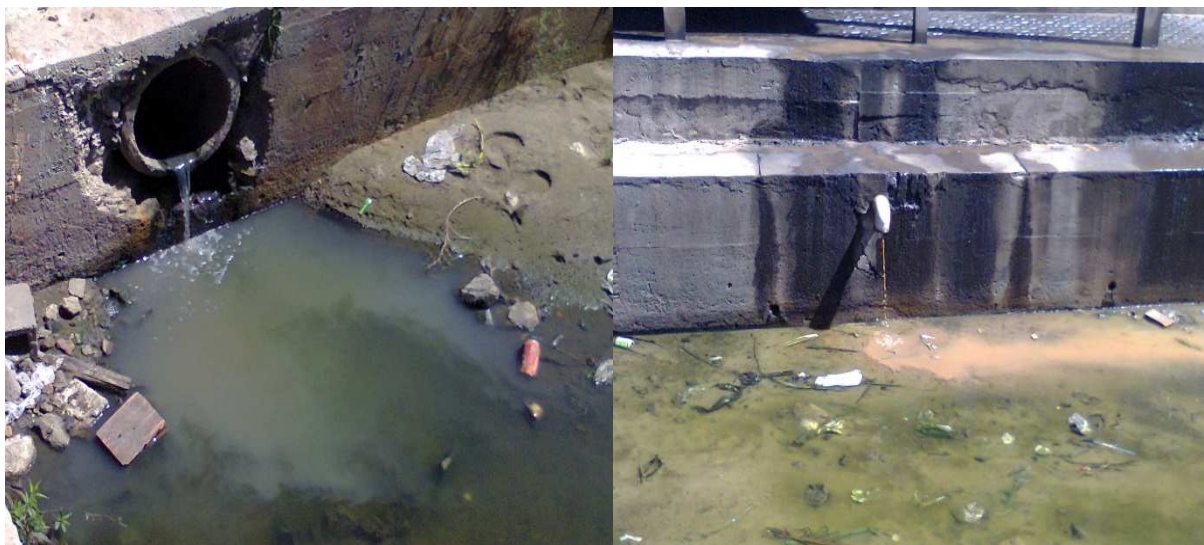
Figura 5-7– Lançamento de esgotos no canal.
