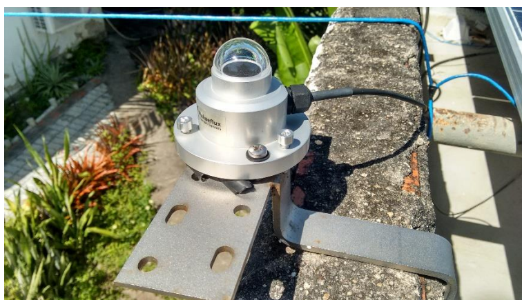
Figura 4.22 – Piranômetro instalado no teto do LEA
