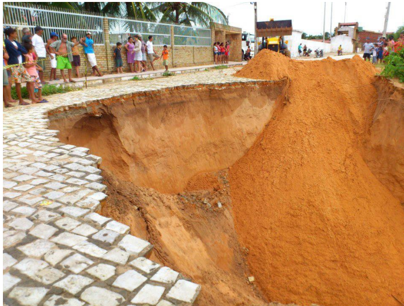
Figura 6 - Cratera na rua que dá acesso ao Estádio de Futebol, nos arredores do centro de Icapuí
