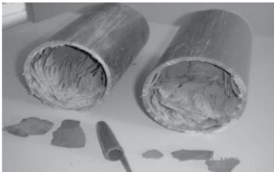
Figura 27: Tubos obstruídos da rede de abastecimento de água. Fonte: Mendonça, 2008.
