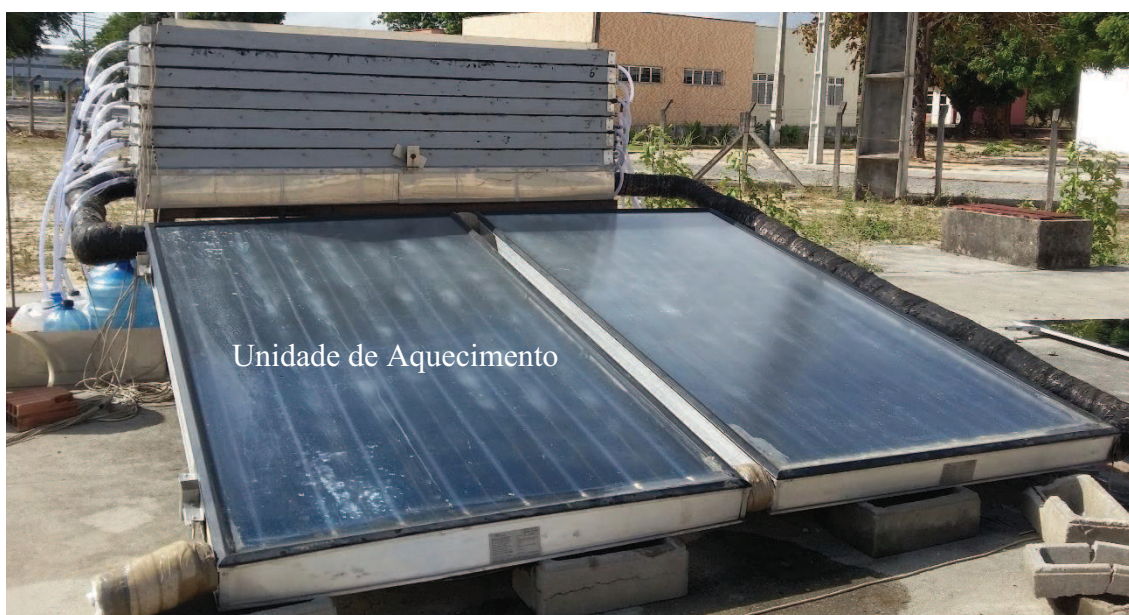
Figura 15: Unidade de Aquecimento.
