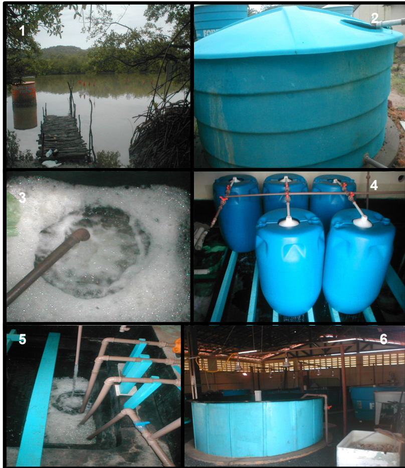
Figura 3 – 1. Afluente (Rio Pacoti), 2. Tanque de desinfecção, 3. Tanque de decomposição aeróbia, 4. Filtro biológico, 5. Tanque de recirculação, 6. Tanque de cultivo.
